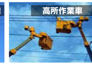
架空配電線/送電線
